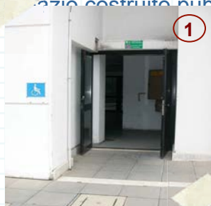
1 Ingresso secondario. Per il passaggio di una carrozzina è necessaria l'apertura di ambedue le ante.
