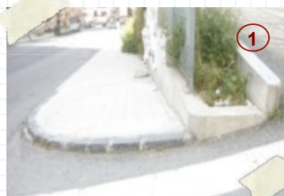
Il marciapiede non è accessibile a persone su sedia a rotelle.
