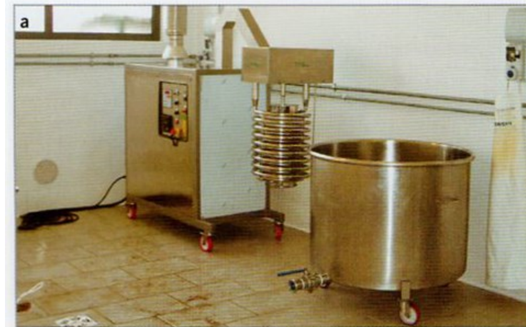
Fig. 8.21 – Un modernissimo impianto per minicaseificio di nuova concezione due caldaie camiciate di tipo diverso, adatte a produzioni diversificate, accoppiate con un potente gruppo energetico e dotate di comandi programmabili computerizzati.
