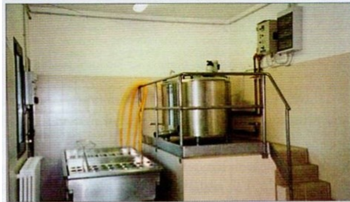
Fig. 8.13 – Sistemazione impiantistica di un minicaseificio con due caldaie da 200 lt accoppiate e gruppo produzione vapore separato: si notino i tavoli a doppio fondo che accolgono gli stampi.
